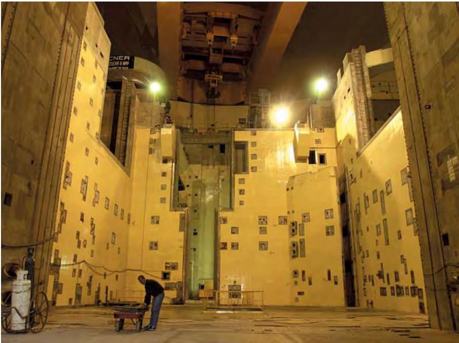
► VISTA DEL INTERIOR DE UNA USINA DE ELECTRICIDAD.
