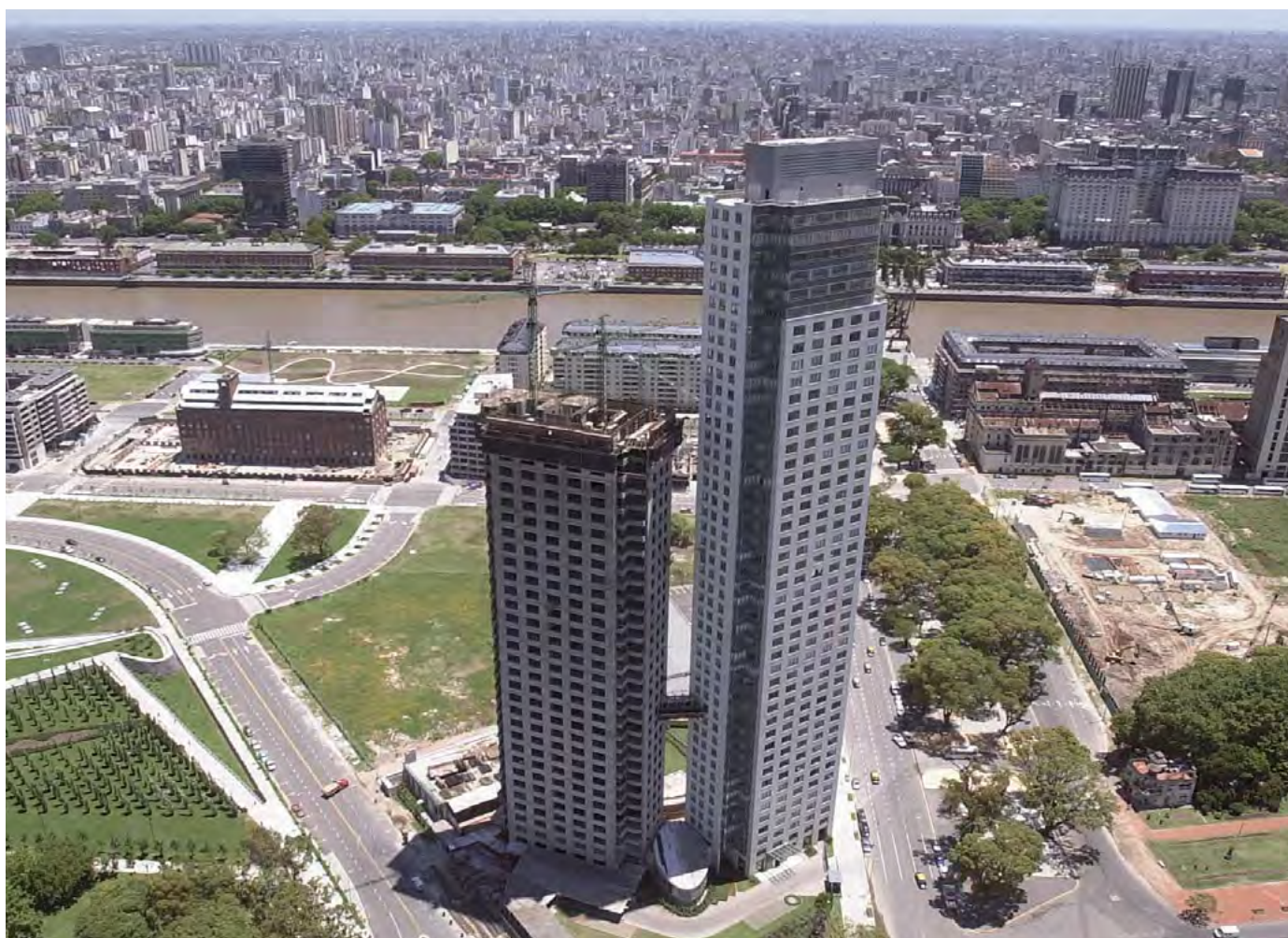
► TORRES DE VIVIENDA EL FARO, DEL ESTUDIO DUJOVNE-HIRSCH. ESTÁN EN CONSTRUCCIÓN EN COSTANERA SUR, SOBRE EL ÁREA ESTE DE PUERTO MADERO.
