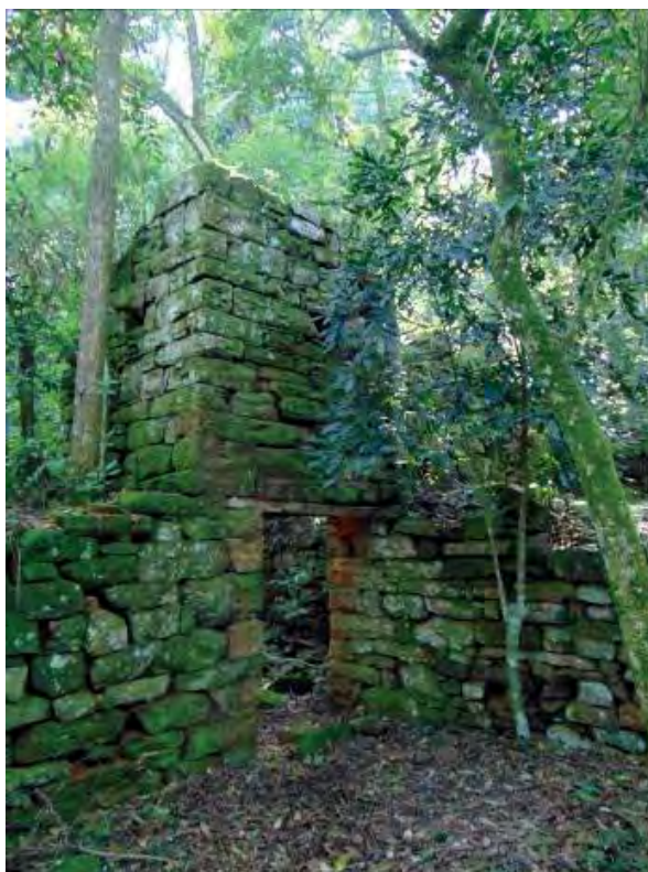
Figura 16. Vano de entrada de la planta baja de la Estructura II de Teyú Cuaré. Nótese el delgado dintel de madera para sostener un primer piso casi derruido en su totalidad.
