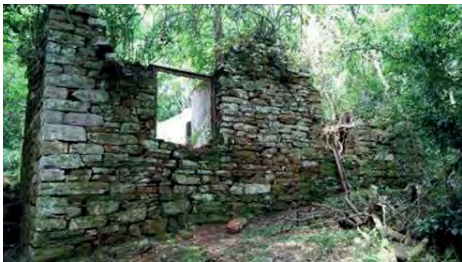
Figura 17. Muro lateral de la Estructura I que aun conserva una ventana de factura industrial; la parte superior del muro se derrumbó en años muy recientes.
