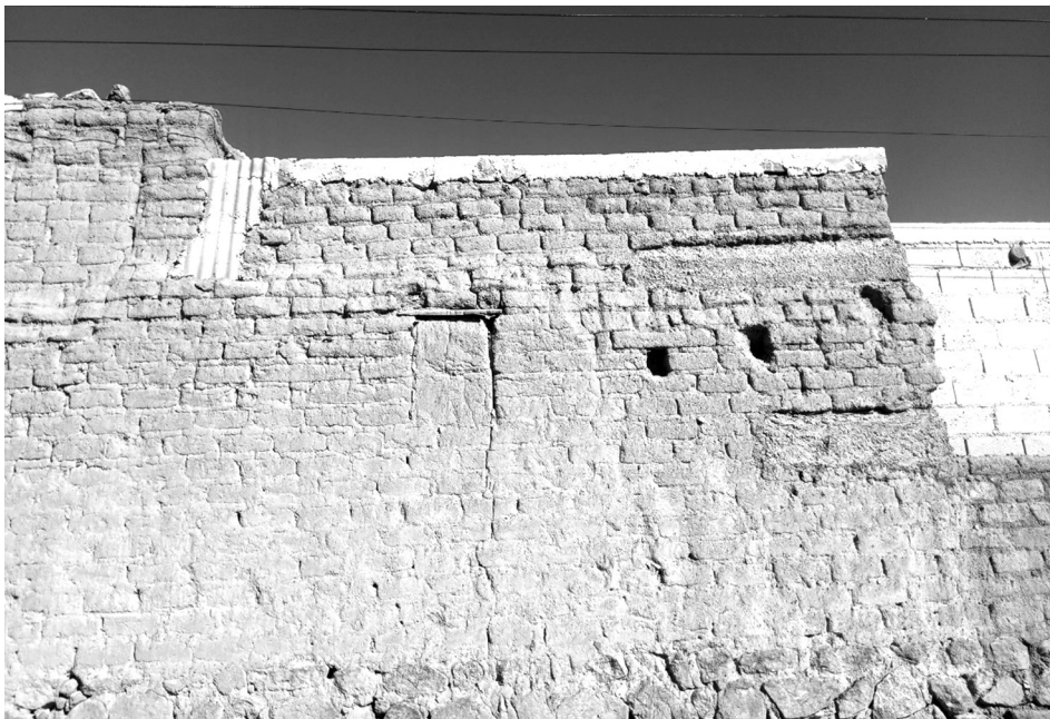
Figura 6: Refuerzos de hormigón armado en muro de adobe en Cochino. Fuente: fotografía de autores (2019).
