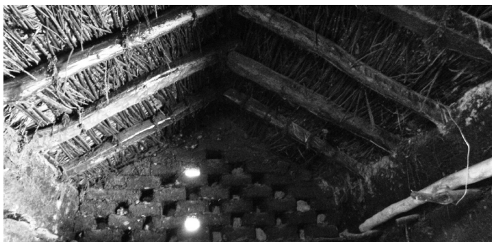
Figura 10: Estructura interna de techo. Se observa los pares, el forjado de chilca y paja. Fuente: Fotografía de la autora.
