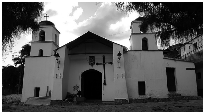
Figura 8: Fachada de la Iglesia de Nazareno, se observa la forma trapezoidal de los muros. Fuente: Fotografía de la autora.
