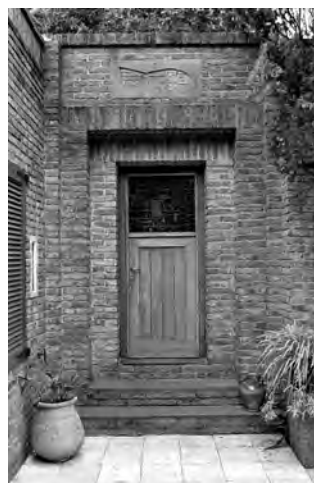
Figura 26: Casa Augusto Torres. Puerta de acceso al vestíbulo. Fuente: Fotografías, Panta Astiazarán, Archivo Leborgne Arocena.
