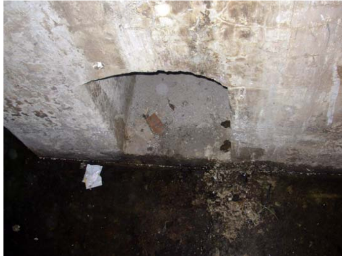
Pasos de circulaciones de diferentes alturas y dimensiones observables desde las rejillas superiores, con agua en el piso.
