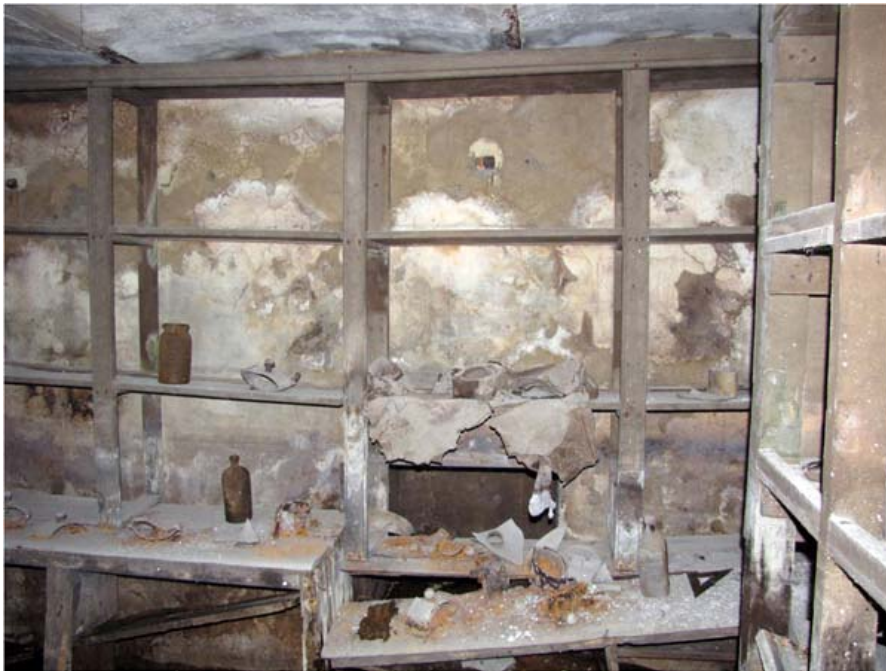
Vista de la oficina escondida del sótano del Edificio B con sus muebles y objetos destruidos por el agua.
