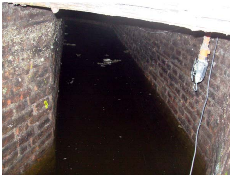
El constante problema de la inundación: nótese el sistema de iluminación bajo el agua tras el primer día de lluvias.
