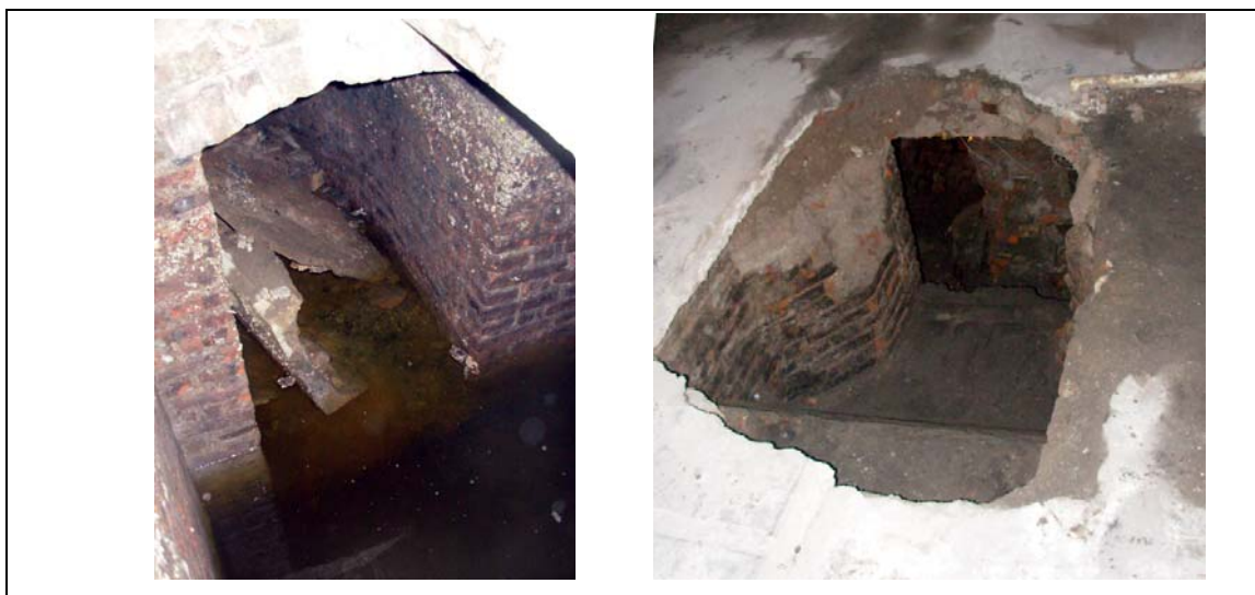
Interior de la galería en que se ven extremos terminados de manera redondeada, uno de los accesos por rampa y uniones de tramos horizontales.
