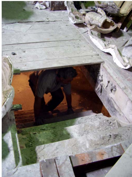
Escalera de madera cubierta por tablonces y ya casi destruida para descender a los sótanos del Edificio B.
