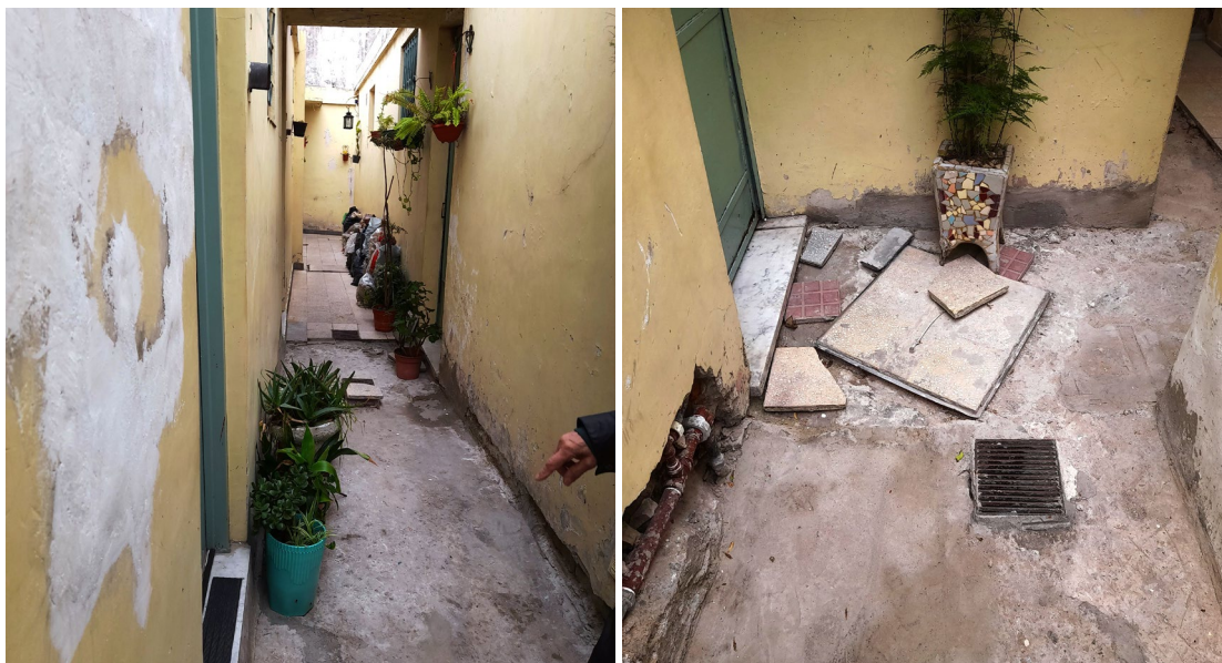
Trabajos de renovación de pisos en el corredor durante las obras actuales, en los desagües pluviales y cloacales, y vista del sector rellenado por el hundimiento.
