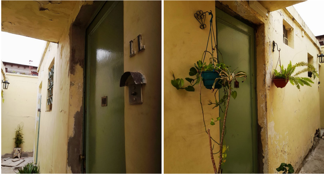
Marcos de puertas desencajadas pese a ser de hierro, producto de los hundimientos.
