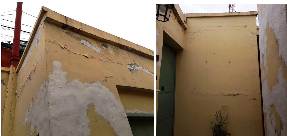
Fisuras producidas por hundimiento del subsuelo, y por movimientos en las losas de las cubiertas debido a dilatación.
