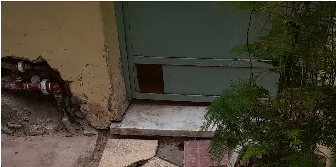
Umbral de puerta descolocado por hundimiento del subsuelo incluyendo la rotura de las instalaciones de agua.
