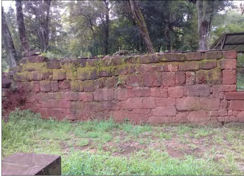
Figura 15. Muro construido en su totalidad de itacurú bien consolidada (Fotografía del autor)
