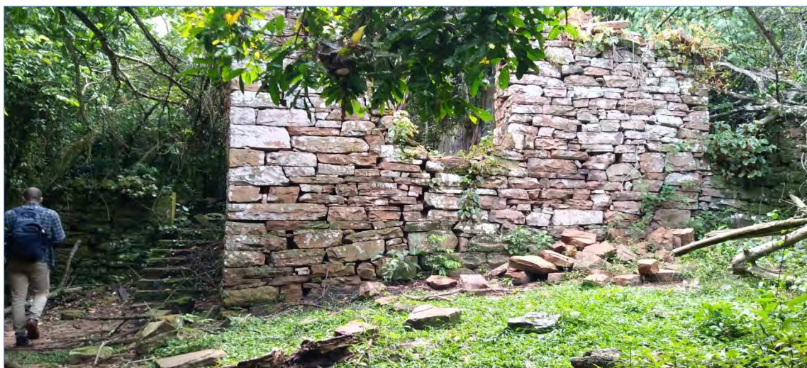
Figura 34. Nótese la mala calidad del aparejo o sistema de colocación de las piedras en los muros.
