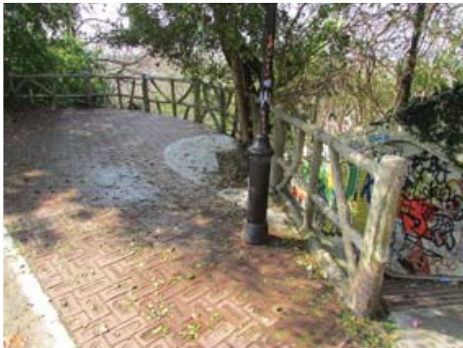
318. Plataforma superior con la baranda de ramazón de la bajada El Potro (Foto F. Girelli 2013).
