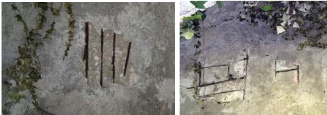
77.78 Hierros de diversos anchos y formas para armar la bóveda de la Gruta de Lourdes de Mar del Plata (Fotos del autor 2012).
