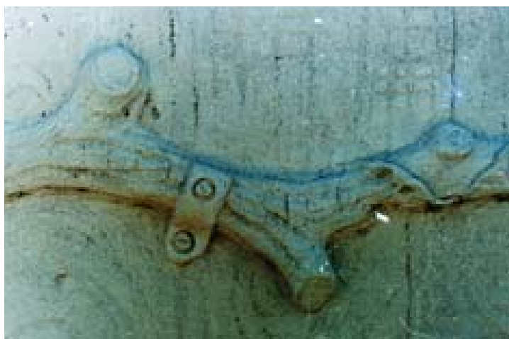
283. Detalle de ramas, soportes con tornillos y grampas sobre la pared de símil tablas; demolida (Foto del autor 1991).
