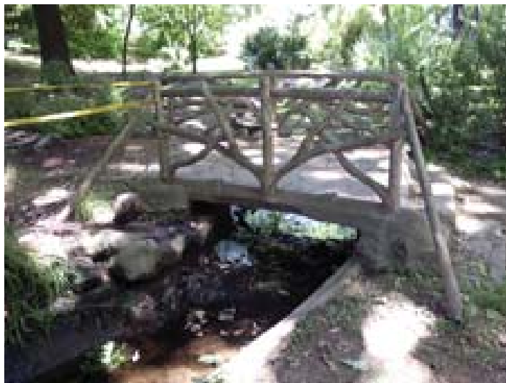
199. El puente visto del lado opuesto sin agua y con la rocalla destruida (Foto del autor 2013).
