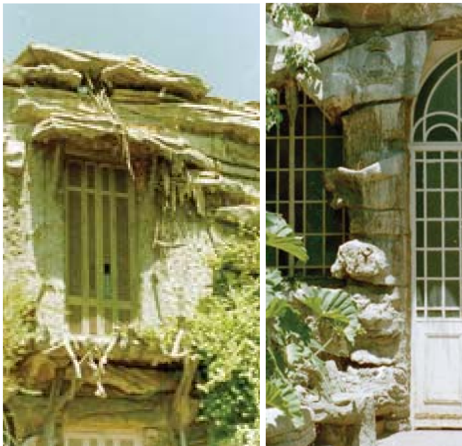
56.57 Estructuras atectónicas: piedras en el techo, columnas de tambores inclinados, en la casa de la calle Cabildo 66, demolida (Foto del autor 1987).
