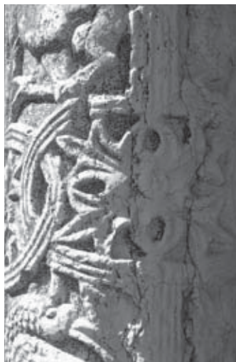
Decoración superficial de la columna de cemento, nótese la diferencia en el material, la forma de rotura y la irregularidad del trabajo. (Fotografía Patricia Frazzi).
