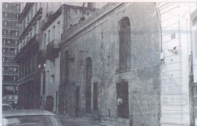
Fachada hacia el callejón 5 de Julio, frente original del edificio, que aunque sin el revoque conserva su estructura de 1850.
