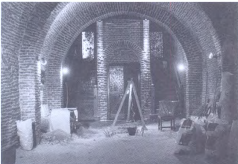
Sector abovedado de la planta baja, sin revoque, muestra el peculiar sistema constructivo de Taylor para este tipo de arquitectura industrial.
