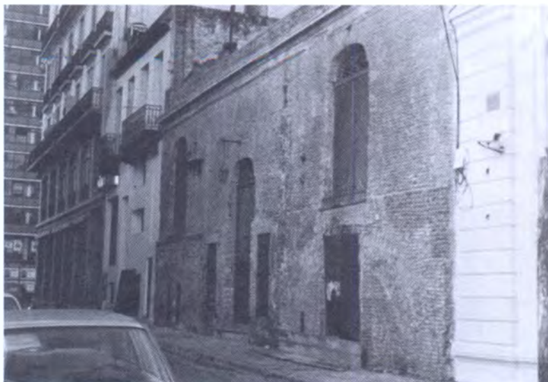
Fachada principal del sector aun existente, sobre el callejón 5 de Junio, muy alterado y sin revoque. Aun quedan parte de las paredes originales, las ventanas, la puerta y la moldura superior.
