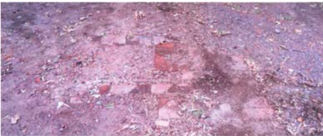
Fotografía de la zona, donde se ven las paredes de los baños surgidas por erosión.
