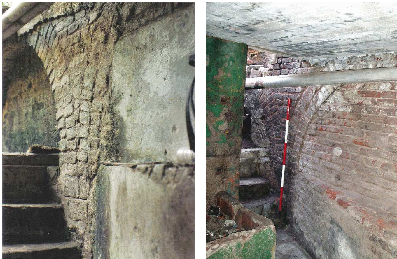
Figura 14. Fotografías del mismo arco en 1986 y 2005, usado para demostrar que la atribución del edificio al Polvorín de Cueli es incorrecta, hallado en buen estado bajo el invernadero actual.
