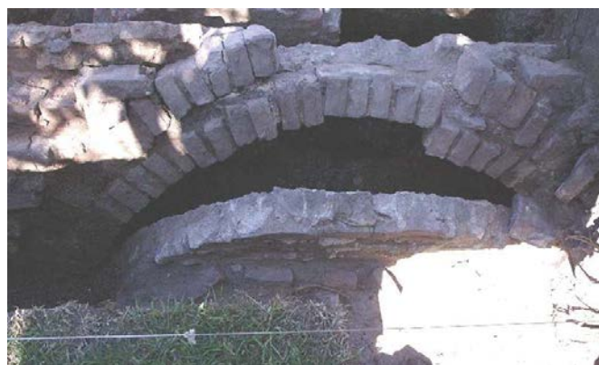
Figura 12. Uno de los arcos que formaban las paredes tras su excavación; eran arquerías a las que se les agregó como cierre una pared de ladrillos cortados.
