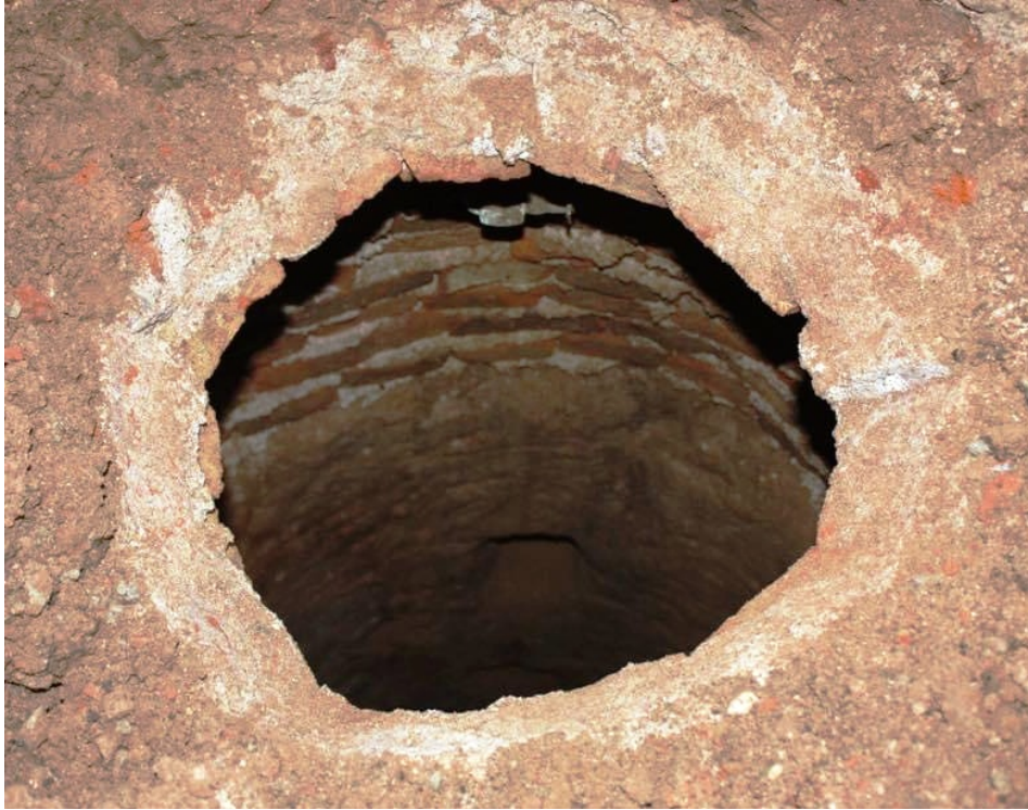
Restos de la bovedilla o cupulín que cubrió el pozo sobre un cilindro de ladrillos, al producirse el derrumbe.
