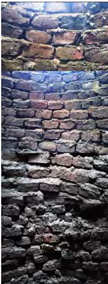
103. Vista de las paredes interiores del pozo y el incremento del deterioro hacia la parte inferior.
