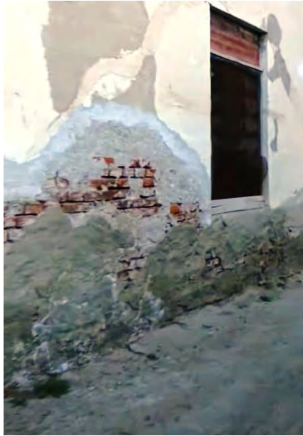
51. Detalle del deterioro producido por el agua de las napas que lavó las juntas de tierra y degradó el revoque de la sección inferior de las paredes. Las imágenes son del exterior de los Ambientes 3 y 4 cuando aun existían.
