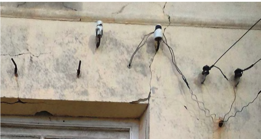
40. Ganchos de hierro de los que colgaba el escudo de la comisaría y restos de la instalación eléctrica posiblemente de 1917, con aislantes de porcelana blanca y marrón en su sitio.
