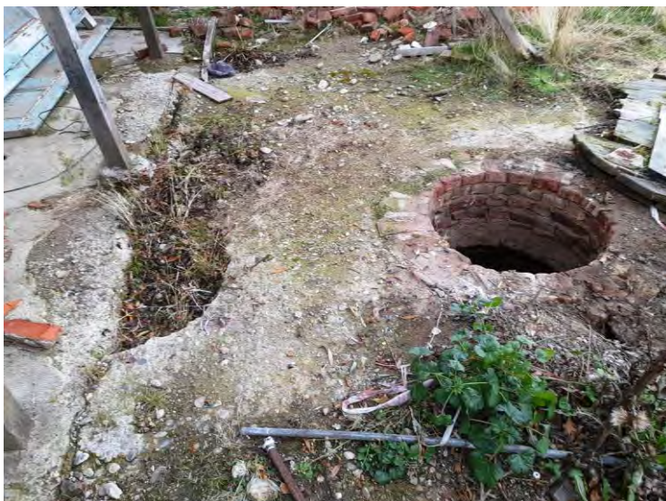
97. Pozo de agua cuyo brocal ha sido destruido y el semicírculo de algún otro pozo ubicado en la salida de la galería al patio.
