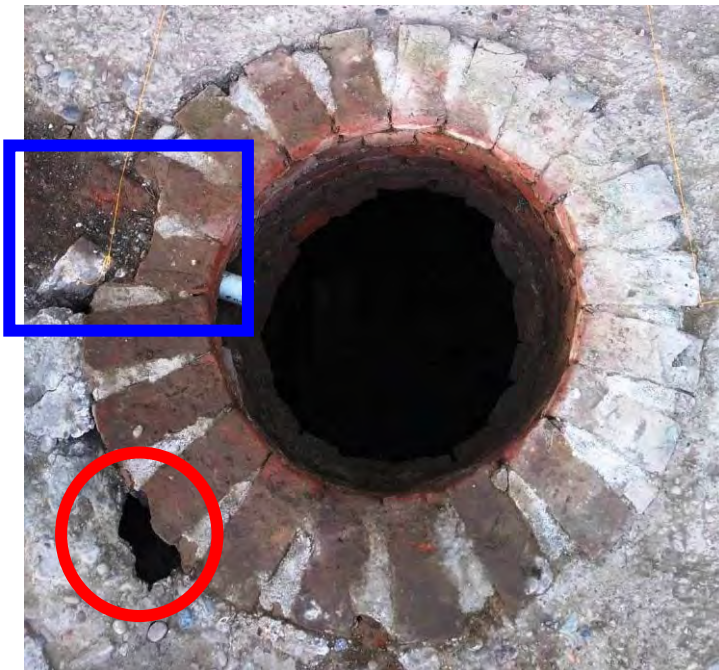
101. Boca de entrada al pozo del aljibe de ladrillos. Nótese en azul la entrada de un caño de PVC que llegaba desde la cocina y usado para descartes orgánicos. El rojo señala los deterioros que se han producido por la inestabilidad del conjunto.
