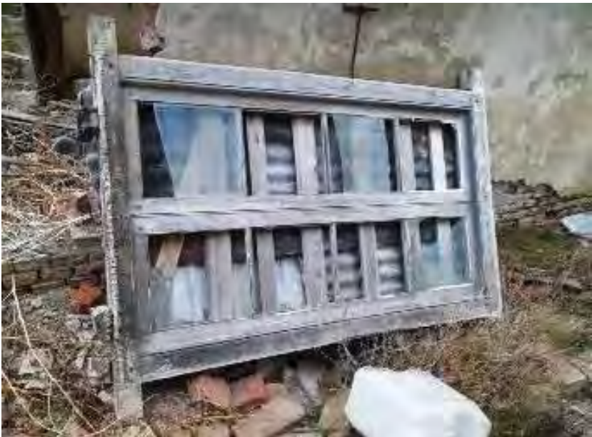
85. Ventana posiblemente del Ambiente 8, movida de su sitio original, cerrada con chapas metálicas y maderas.
