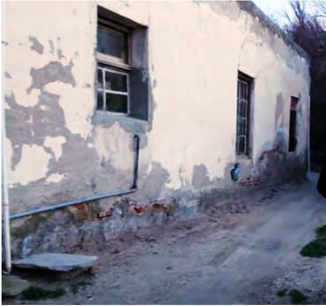
14. Entrada por el lado Oeste tal como se lo veía antes de la demolición, delimitada con árboles, con los fondos de los Ambientes 1, 2 y 3 (Cortesía P. Walker).
