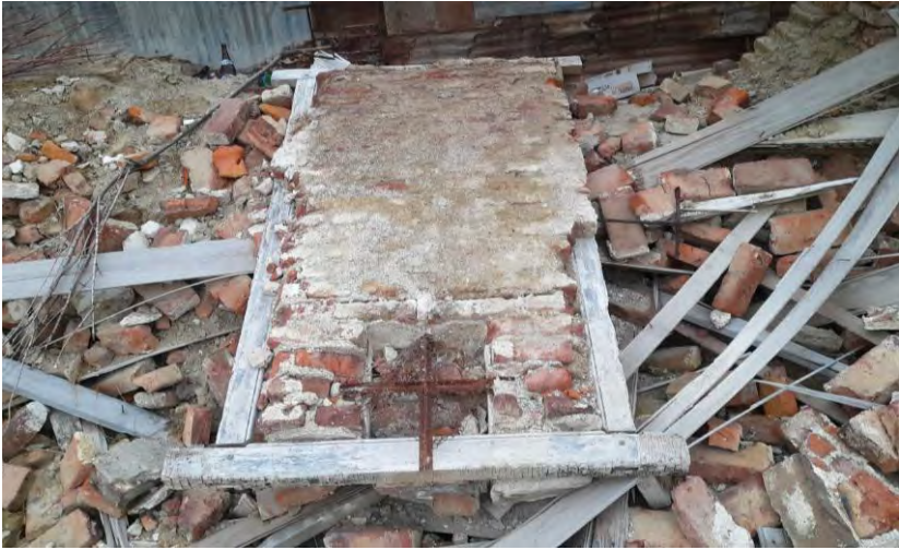
84. Ventana del Ambiente 9, con reja hecha con hierro T en un pequeño espacio cuadrado para comunicarse con el exterior, el resto fue tapiado con mampostería. Fue colocada sobre el escombros después de la demolición.
