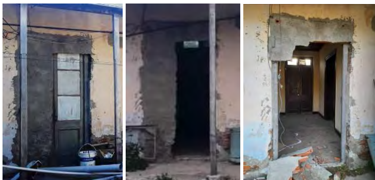
44- 45. Deterioro de la puerta de la galería al patio entre 2016 y 2022.
