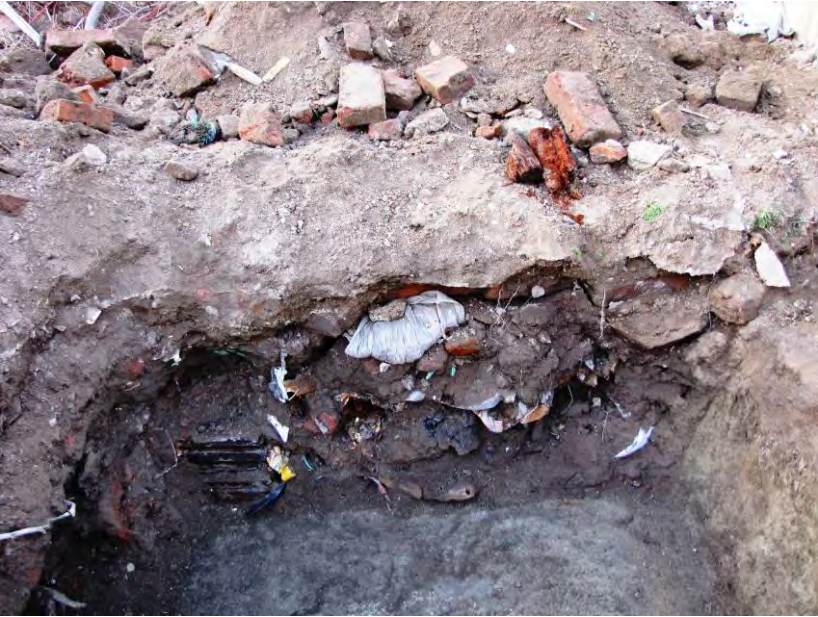
111. Basura reciente que rellenaba la cámara de aire bajo el piso.
