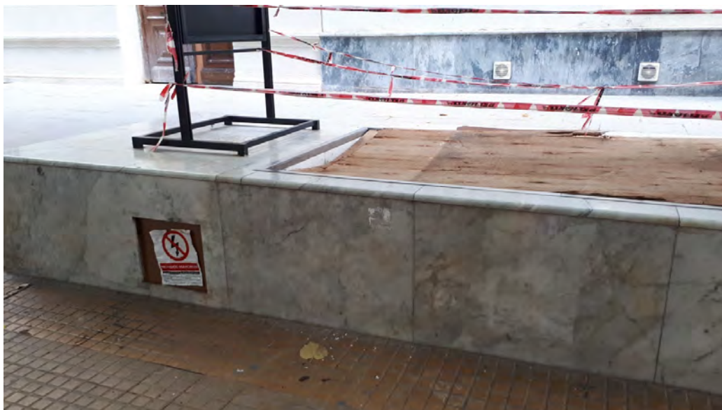
Sector de ventilación protegido con los elementos vandalizados en su interior y cinta de seguridad perimetral
