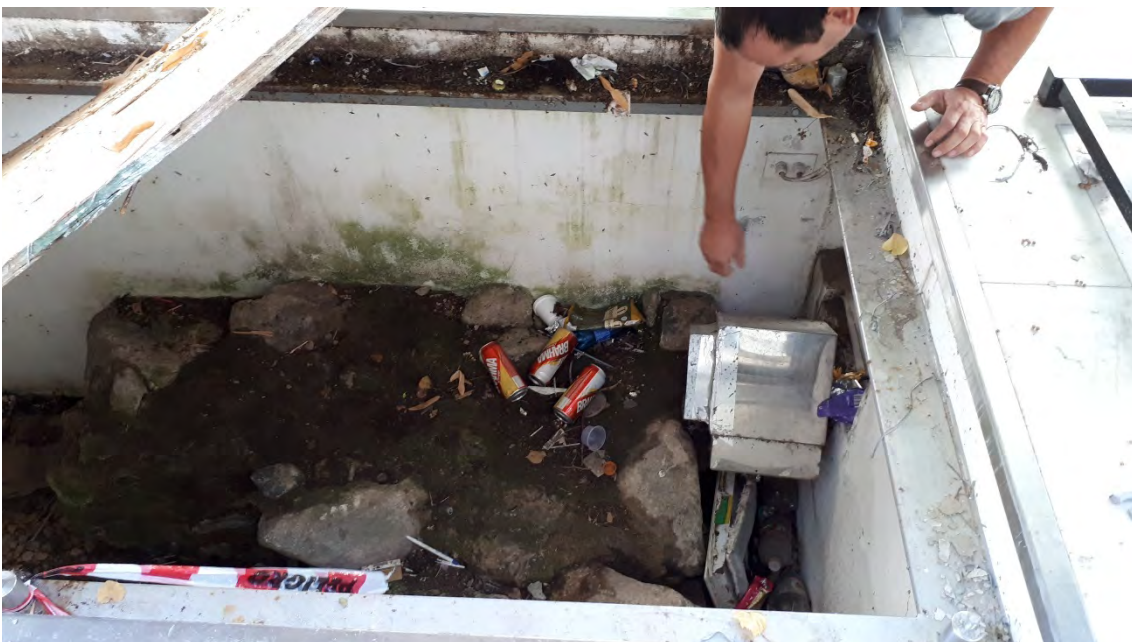
Sector de ventilación vandalizado, desechos, acumulación de sedimento y presencia de insectos y hongos
