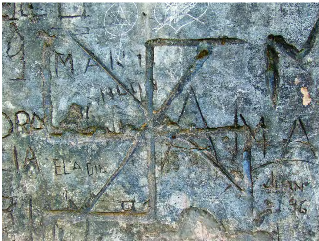
Figura 69. Detalle de una de las paredes internas de la Estructura I completamente cubierta por grafitis.
