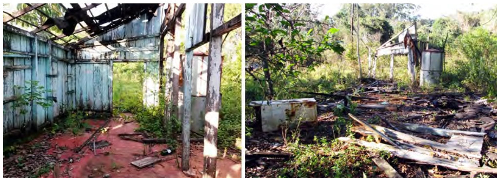
Figura 146. La Estructura D ya incompleta en el año 2015 y su estado en 2018, mostrando la velocidad de destrucción en la zona.
