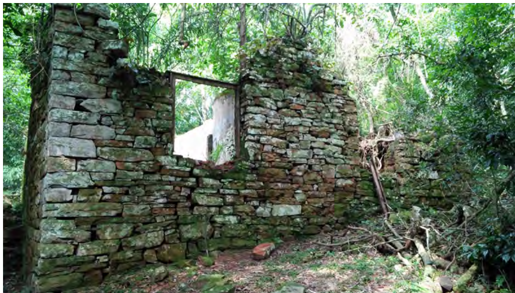
Figura 12. La misma pared en 2019 con parte del muro de la ventana derruido.
