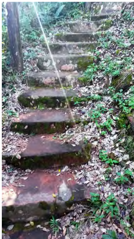
Figura 134. Una de las escaleras de piedra construidas dentro de los terrenos de la misma chacra.
