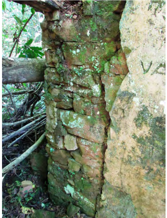
Figura 95. Evidencia de la falta de unión en los ángulos entre los muros, lo que llevó a la caída del revoque y luego de los muros superiores.
