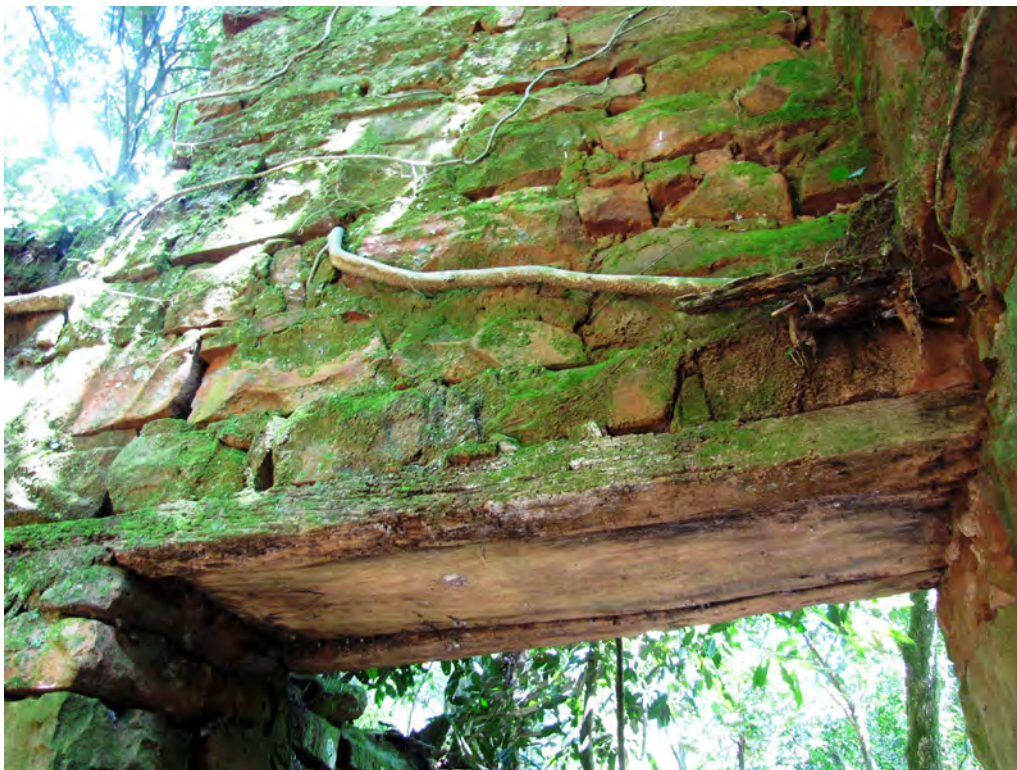
Figura 93. Entrada a la planta baja: el frágil dintel hecho con vigas, una tabla y piedras cementadas, ahora quebrado y cerca del colapso.
