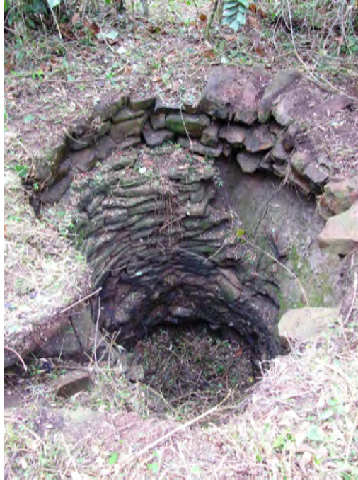
Figura 150. Pozo de agua del sitio colmatado por el derrumbe de uno de los muros laterales.
