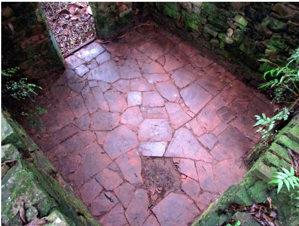
Figura 163. Piso de lajas de la estructura una vez limpia, la piedra que falta estaba ausente.
