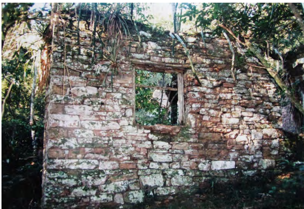
Figura 11. Lateral del Edificio I en 2008 cuando sobre la ventana, aun entera, habían seis hiladas de piedras. (Cortesía A. Cardozo).
