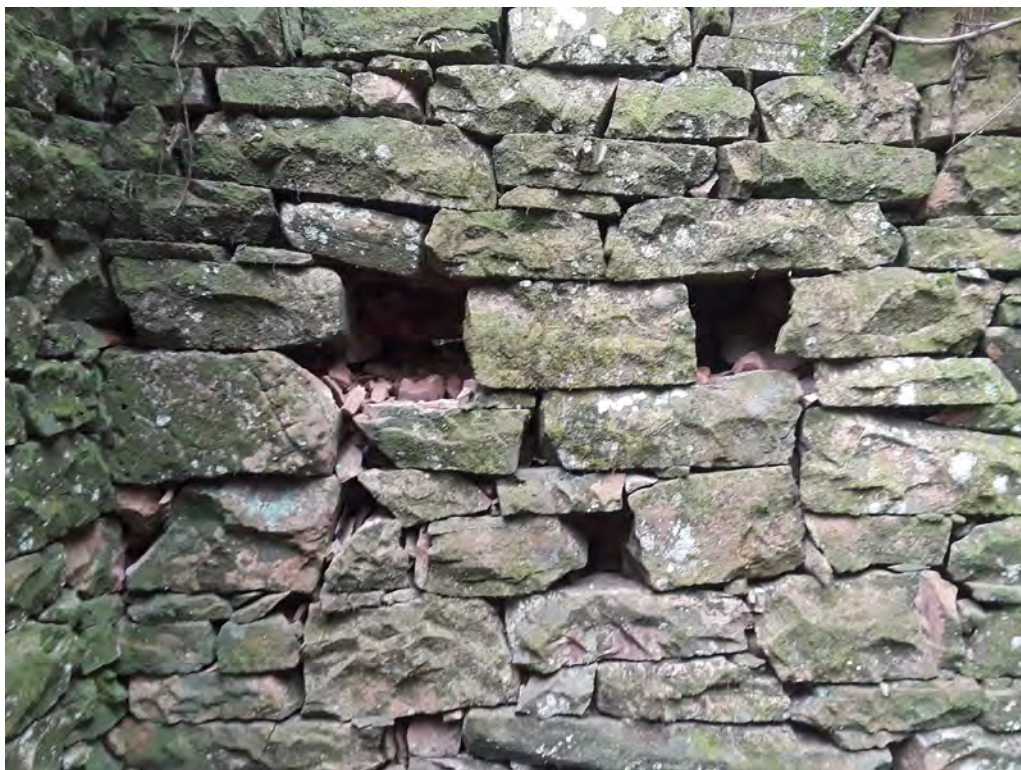
Figura 98. Mechinales o marcas de las vigas de madera que sostenían el primer piso, aun visibles en uno de los muros. Es evidente la mala calidad de la estructura.
