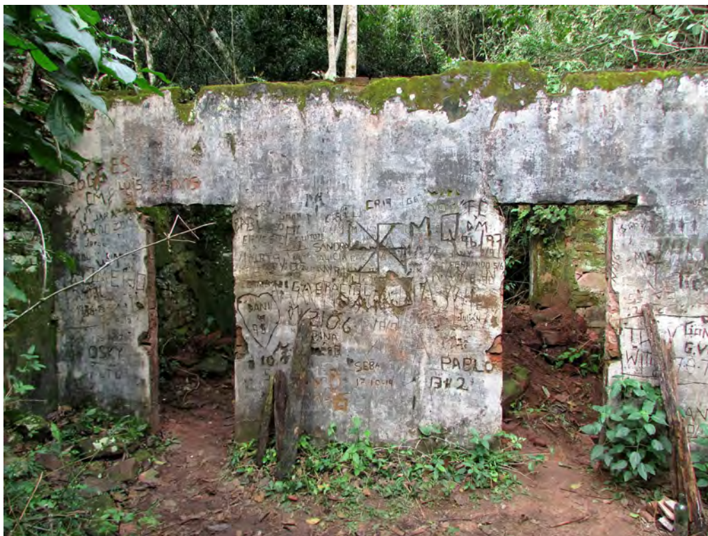
Figura 44. Salón principal de la casa con las paredes internas hechas de ladrillo revocado, ahora cubiertas de inscripciones modernas.
