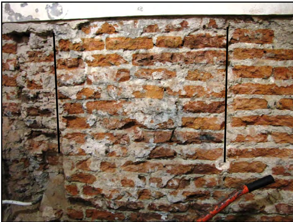
Evidencia de alteraciones en los muros de las celdas: restos de una posible puerta que fue tapiada.
