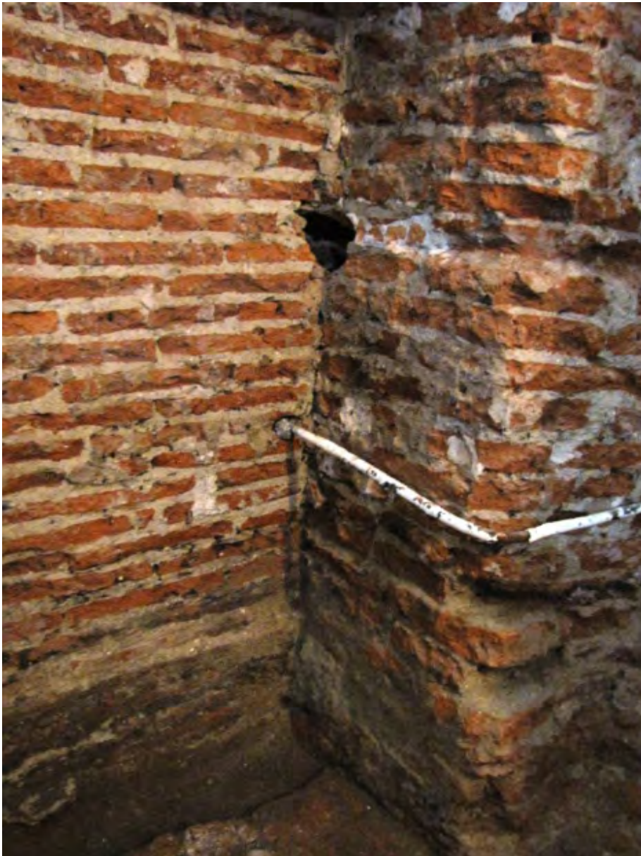
Muros de división entre celdas: se observa que son de ladrillos de diferentes tamaños y sin traba con las paredes laterales.
