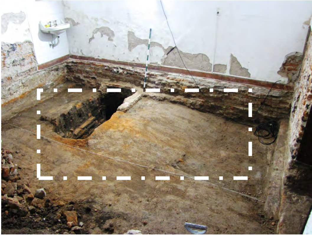
Sector del piso abovedado asociado a los cimientos y a la cámara. Posiblemente una deformación del suelo producto de la construcción de los muro laterales, ante la falta de homogeneidad del piso.
