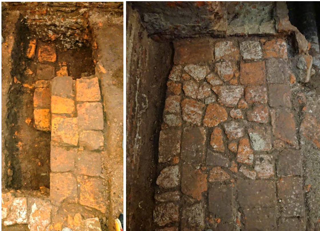
Dos cimientos del interior de la Celda 3: a la izquierda posiblemente del siglo XVII hecho con dos hiladas y a la izquierda la zapata lateral, debe ser de las primeras construcciones en el sitio. A la derecha otro cimiento, del siglo XVIII tardío o inicios del XIX, hecho con la técnica tradicional de usar fragmentos de diversos tamaños y proveniencias.
