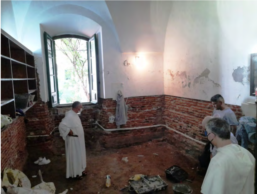
Vista de una de las celdas antes de iniciarse los estudios, cuando los operarios y los frailes observaron la existencia de cimientos y muros casi a medio metro de profundidad por debajo del nivel de piso actual y detuvieron la obra.
