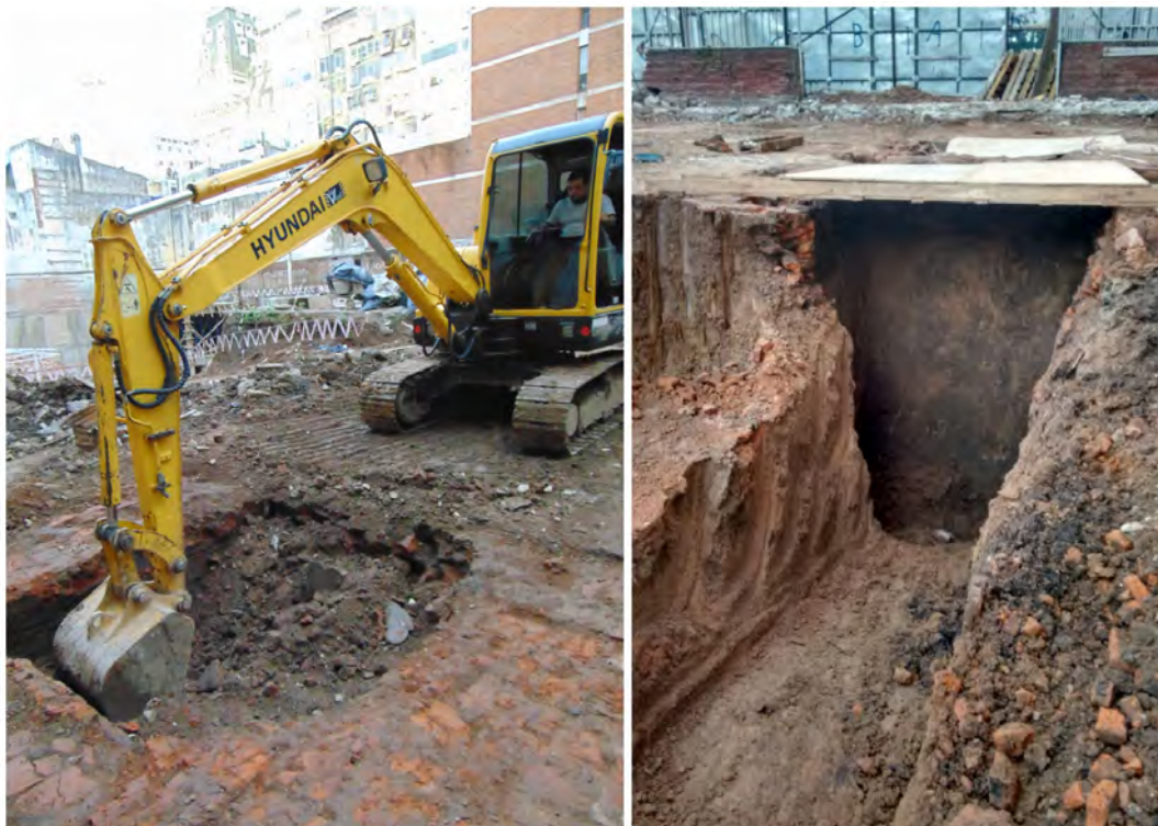
Figura 8. Izquierda: vista del pozo rectangular 1 durante el vaciado por parte de la retroexcavadora del nivel superior cuyo relleno era material moderno. Derecha: vista del pozo con la cara sur abierta. Debido a que el revestimiento superior de ladrillos se encontraba en muy mal estado, se decidió abrir luego las caras este y oeste para el trabajo arqueológico sin riesgos (Foto: A. Igareta).
