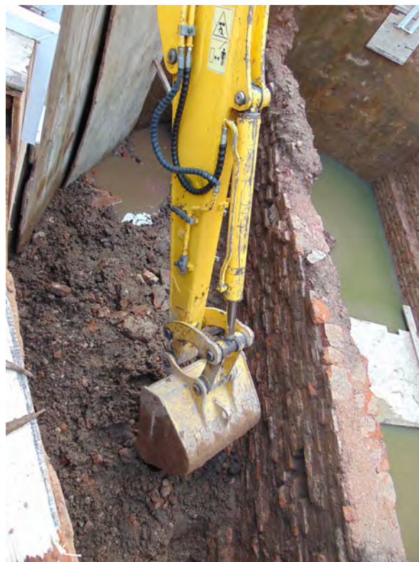
Figura 5. Fenólicos (tablas de madera) ubicados en el lateral de la cisterna mientras la pala de la retroexcavadora retira el relleno de la misma (Foto: A. Igareta).
