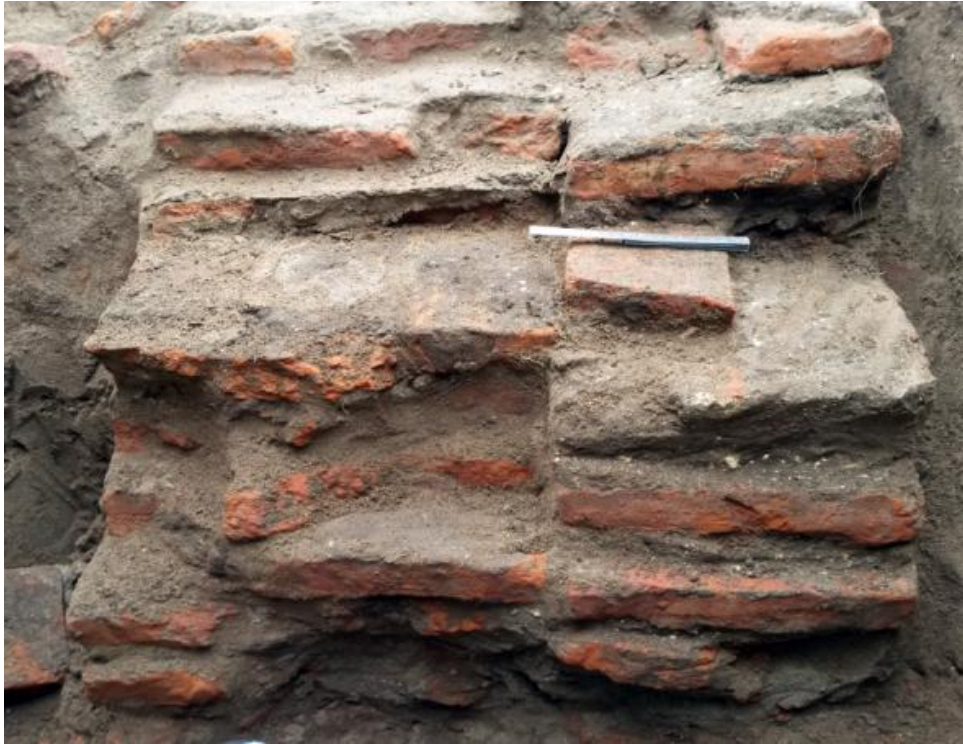
Detalle del aparejo del cimiento con la junta de tierra y cal pobre.
