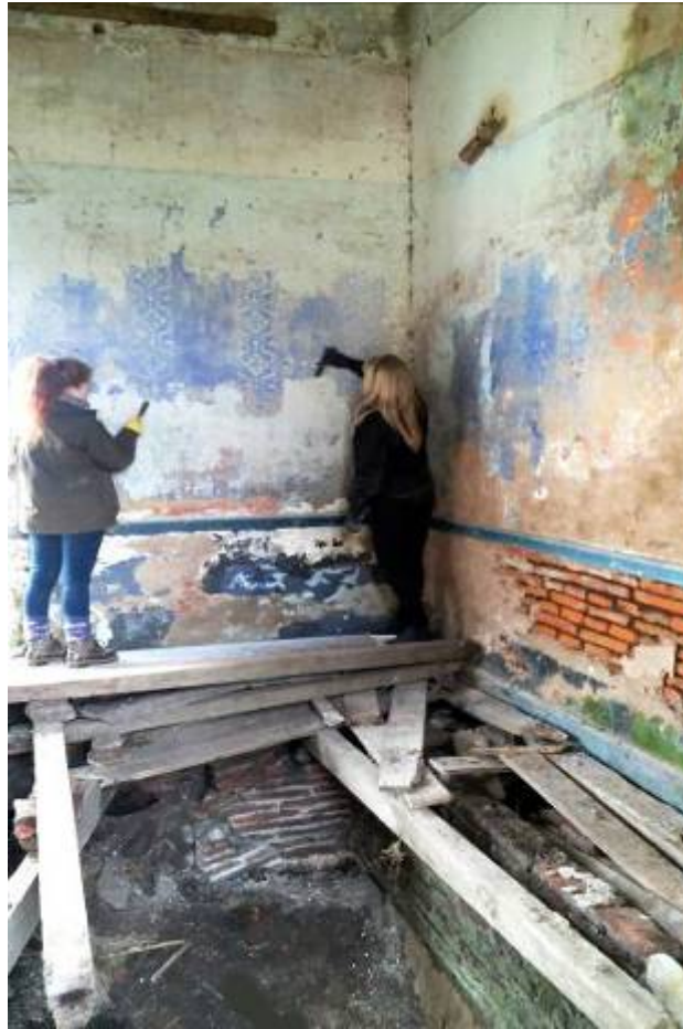
Fig. 1. Sótano y habitación derruidos del sector antiguo del edificio, que fuera usado en 1893-94 como Comandancia. Nótese los estarcidos de color azul mientras son limpiados de las pinturas sobrepuestas 1 .
