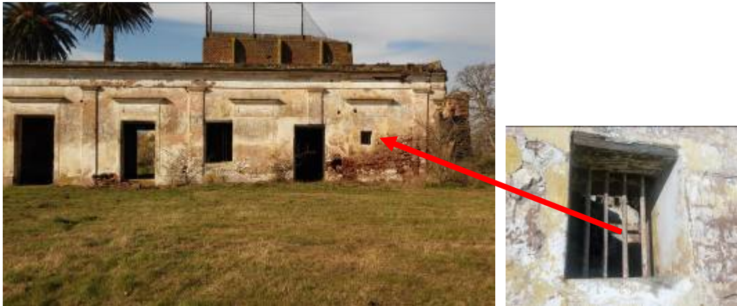
Figs. 8 y 9. Ventana de la considerada “cárcel” en el sector antiguo del edificio, donde funcionaron las autoridades entre 1893 y 1894. Se hace evidente que los arreglos del frente son posteriores.
