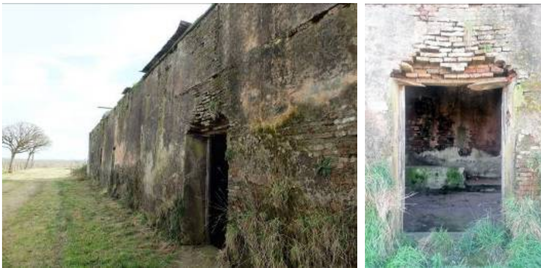
Figs. 19 y 20. Fachada al norte: la más antigua; nótese la falta de ornamentación, la evidencia de una galería exterior y la falta de dinteles adecuados.
