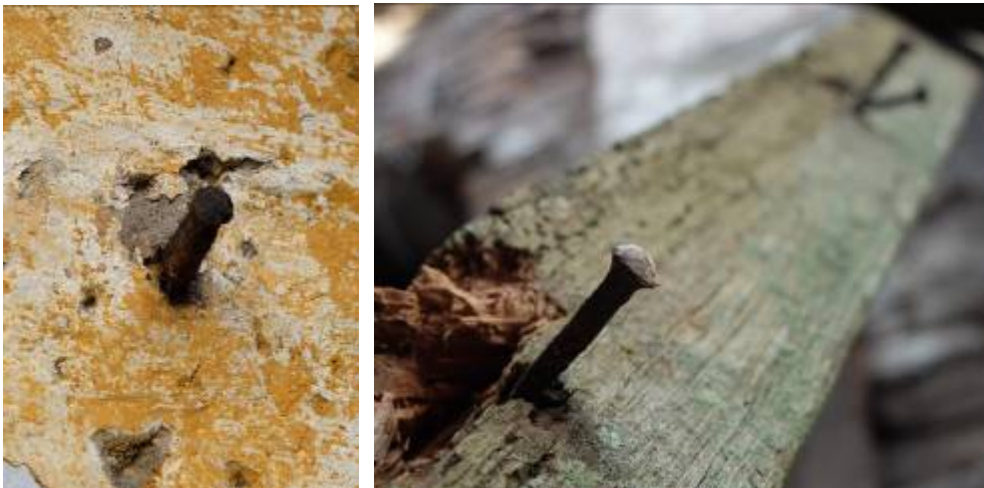
Figs. 11 y 12. Clavos de perfil cuadrado en el sector Sur del edificio, nótese las capas de pintura blanca y luego amarilla sobre el revoque original, los tirantes de madera son de carpintería mecánica.
