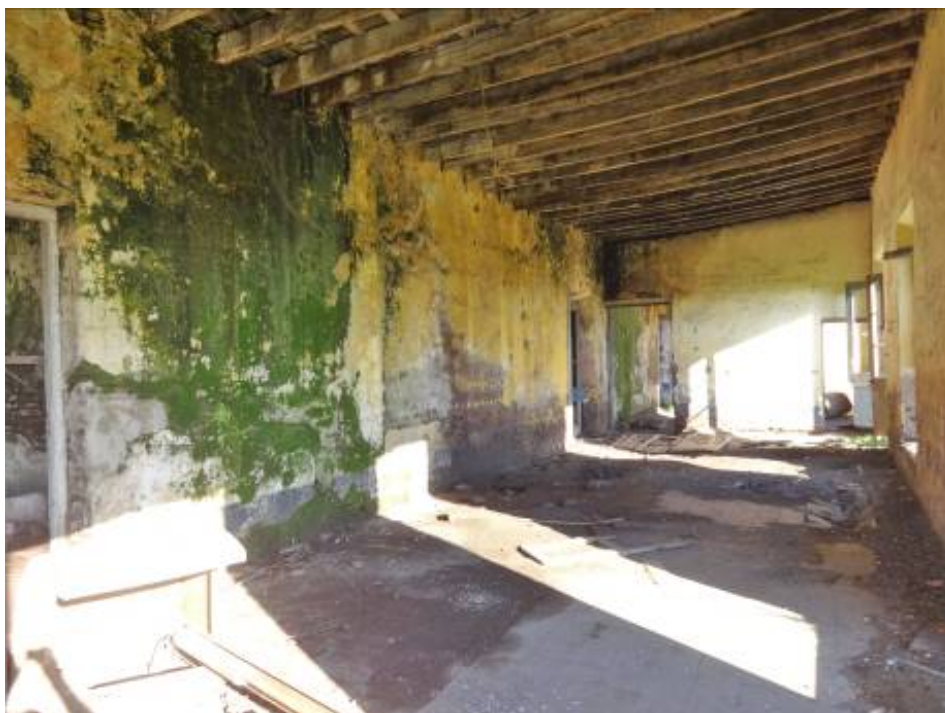
Fig. 26. El mismo salón en 2014, aun quedaban parte de las ventanas y puertas.
