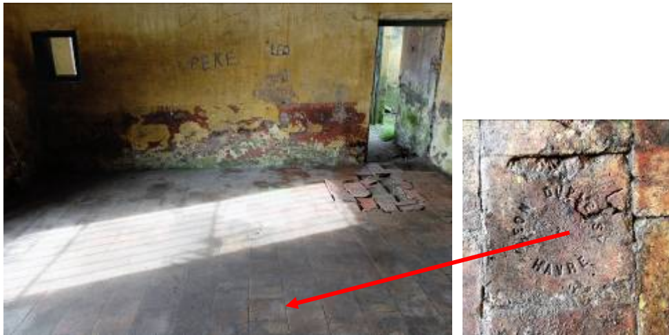
Figs. 34 y 35. Habitaciones de la escuela, la primera con baldosas francesas, una de ellas colocada intencionalmente invertida, y el hundimiento de un sector que ya había sido reparado.
