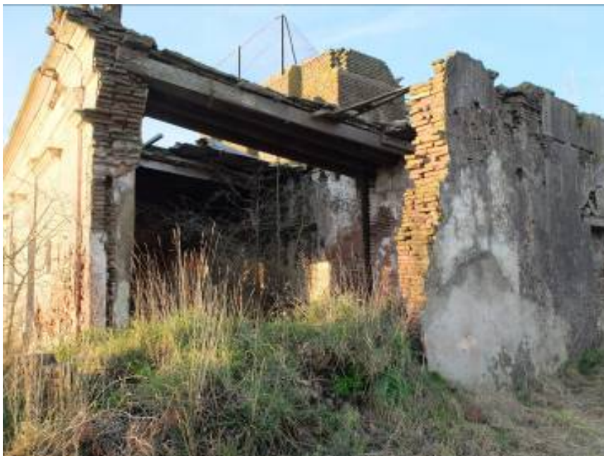
Fig. 44. Esquina derruida coincidente con la sección más antigua, nótese la diferencia de decoración en las fachadas.
