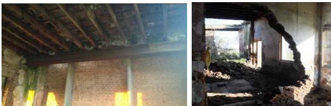
Figs. 48 y 49. Viga de acero y columnas de hormigón para sostener la cancha de pelota cuyos empujes destruyeron el sector, la pared muestra la transmisión de los esfuerzos.
