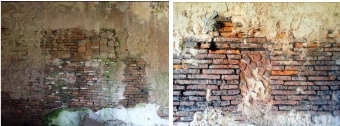
Figs. 58 y 59. Parches en los muros hechos con materiales del sitio pero en diferentes épocas.
