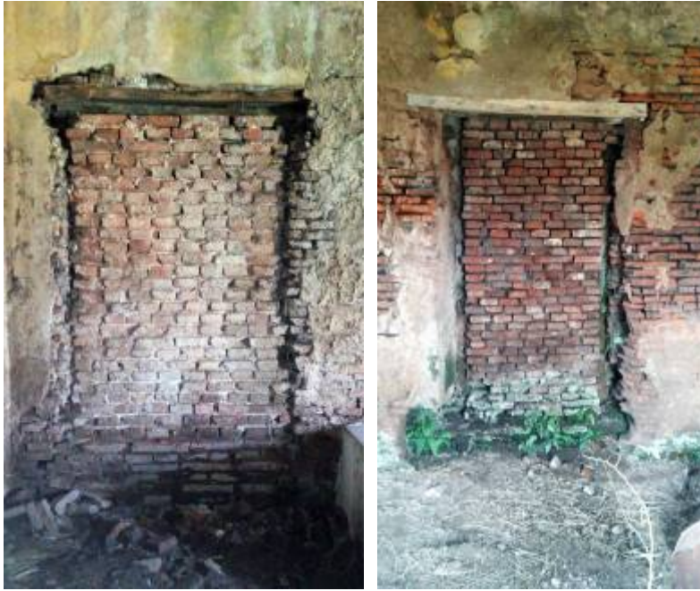
Figs. 60 y 61. Puertas con dinteles de madera de época diversa cerrados en el siglo XX para ampliar el lugar, con ladrillos que no son del sitio.
