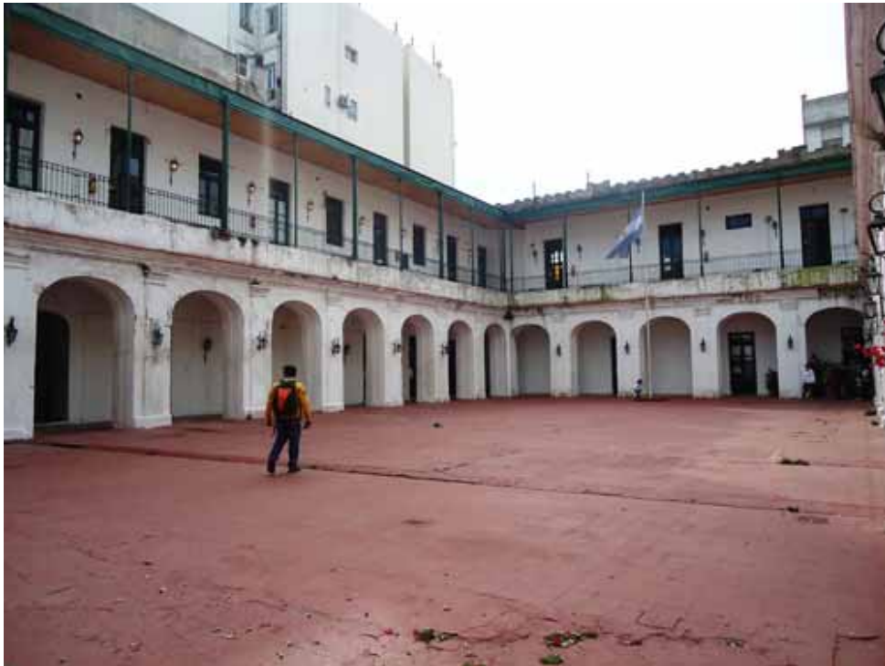
Vista actual del primer atrio y el único restante completo del conjunto, mirando hacia la entrada actual; todos los muros están chorreados de humedad. El piso superior fue agregado en 1883.
