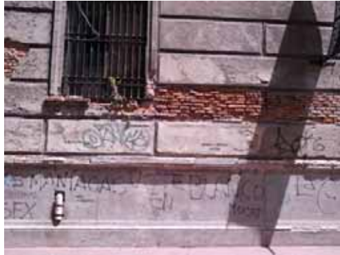
Deterioros en la fachada.
