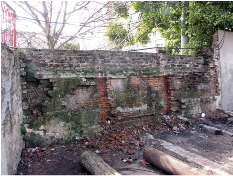
Muro Reid en su cara sur, nótese que la parte superior es moderna y que se observan las áreas alteradas y en proceso de derrumbe, rotura y deslave.
