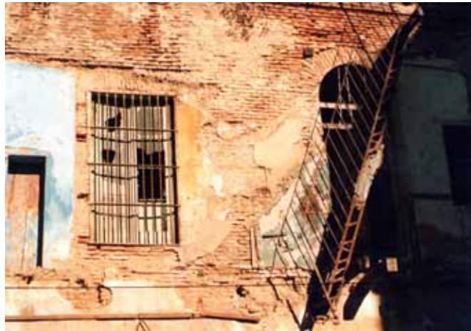
Imagen del deterioro en el tercer patio (1986).
