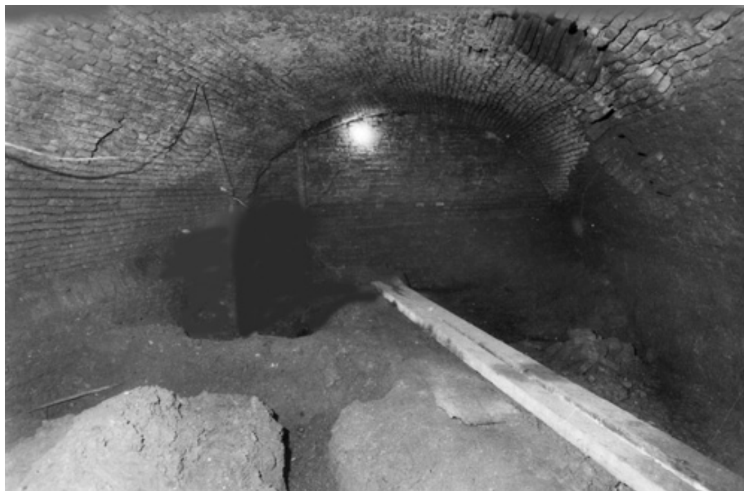
El túnel al inicio de las investigaciones, ya había sido retirado más de la mitad de su relleno.
