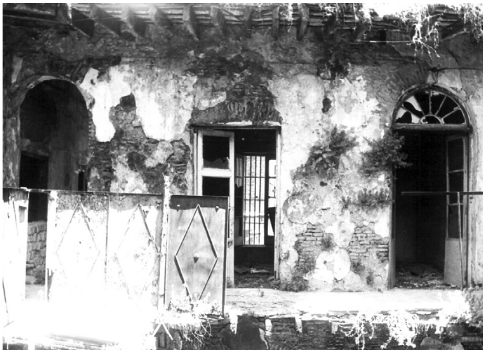
Vista del primer piso del patio delantero en el estado en que se encontraba en 1986.
